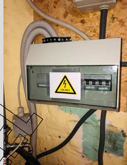
( Elektrisch verdeelbord - Foto buiten )
