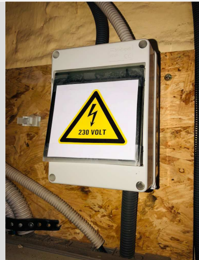
( Elektrisch verdeelbord - Foto buiten )
